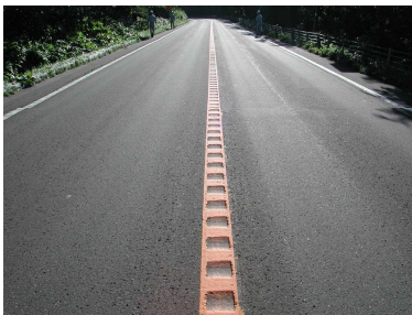
写真2-7. 追越禁止黄色1条線区間設置状況
