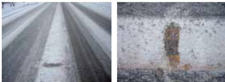
写真5-8. 測定時の路面状況 (R274 日高町 H16.1.20)
