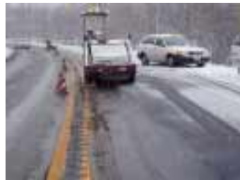
写真 4-3. 積雪や路面の段差により区画線が削れてしまった例
