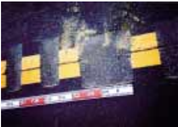
写真 4-2. 凍結路面により不均一な溝の施工例
