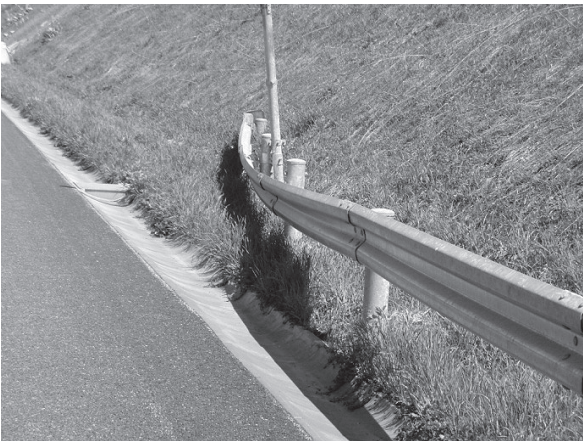
写真－３ ガードレールの脱落状況
