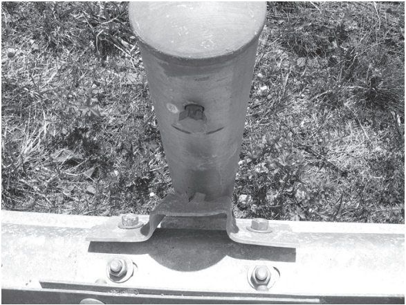
写真－４ ブラケットの破損状況
