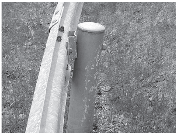
写真－6 板の上部から下向きに変形している状況
