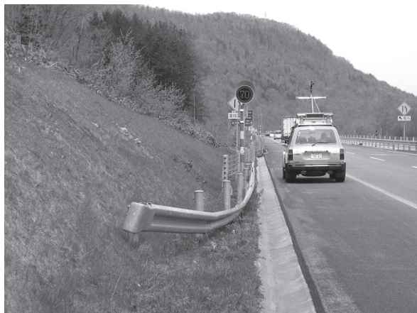
写真-2 脱落状況
