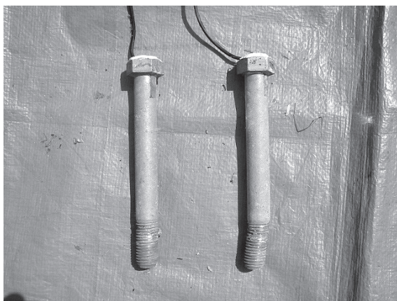
写真－5 脱落したボルトの状況 (写真提供：北海道開発局旭川道路事務所)
