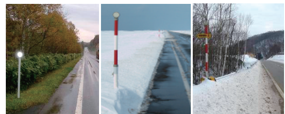
(視線誘導標) (伸縮式の視線誘導標) (スノーポール)
