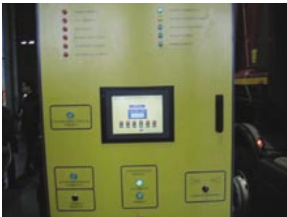
写真-18 塩の積み込み制御装置
