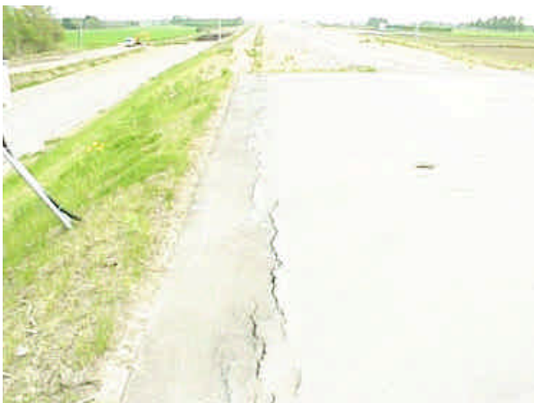
写真 - 5 クラック状況
