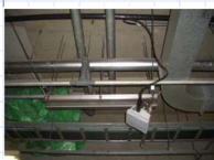
入口車路DSRC アンテナ取付状況
