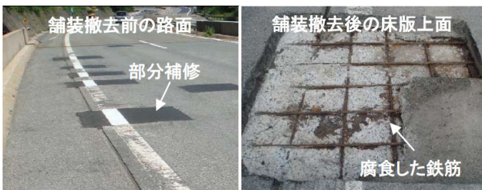
▲ 塩化ナトリウム散布による道路構造物の腐食
