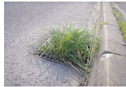
排水工の清掃忘れ
