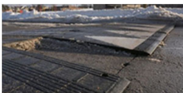
▲ 除雪ドーザで作業中にハンプ傾斜部がプラウで損傷したケース (カナダ・オンタリオ州ハミルトン)
