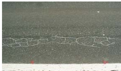
A断面に発生した疲労ひび割れ
