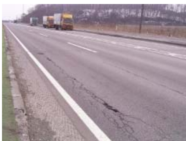
疲労ひび割れが発生した状況 (一般国道36号苫小牧市美沢)
