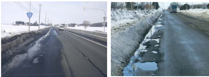
写真-1 融雪期に発生したポットホール
