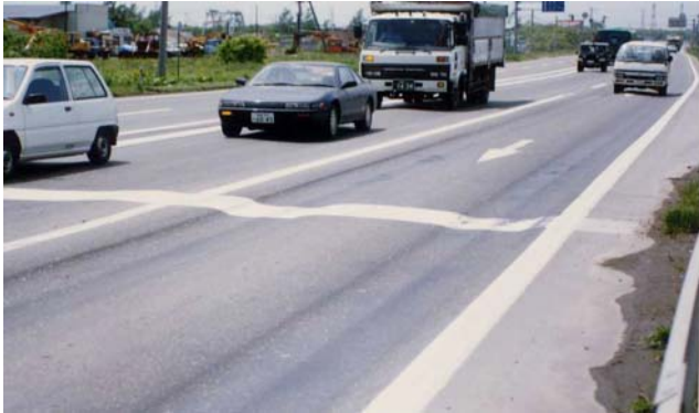
わだち掘れ進行状況
