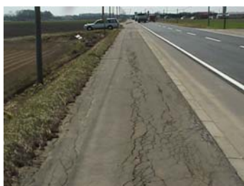
歩道の被害状況
