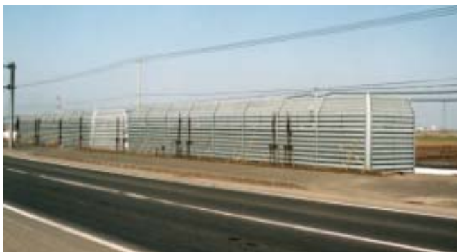
写真3-3-5 吹き止め柵の端部をL字型に加工した副防雪柵の事例（一般国道337号）
