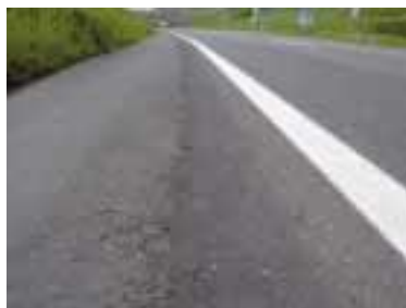
写真 4-8. 路肩に段差がある状況
