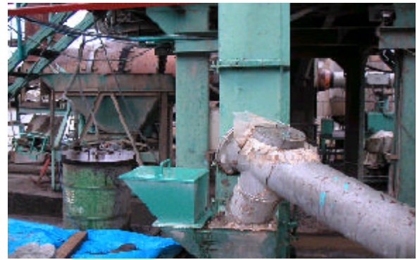
写真 - 4 石粉投入装置外観
