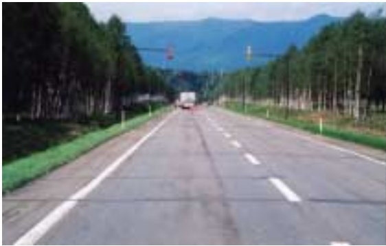
写真-2 低温クラック発生状況（補修後）
