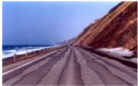
写真-1 スパイクタイヤ規制前の舗装路面の摩耗
