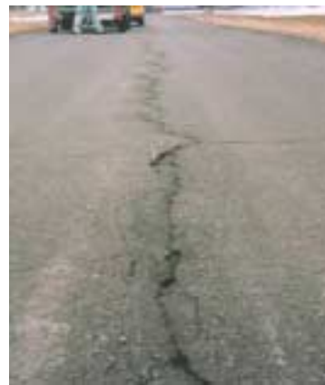
写真-3 凍上による縦断クラックの発生状況
