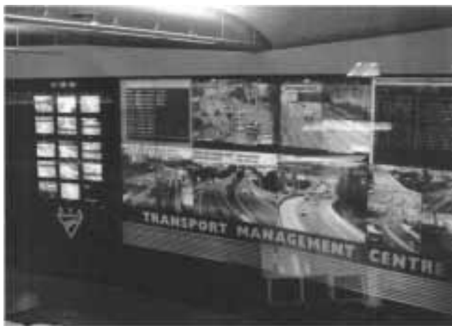
写真 - 10 オペレーションルームのビデオスクリーン
