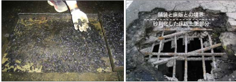
混合物のはく離
